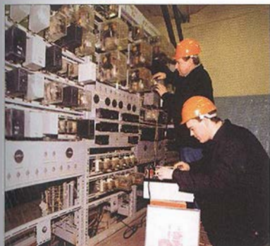
Проверка релейной защиты на подстанции портативным прибором «РЕТОМ-11»
