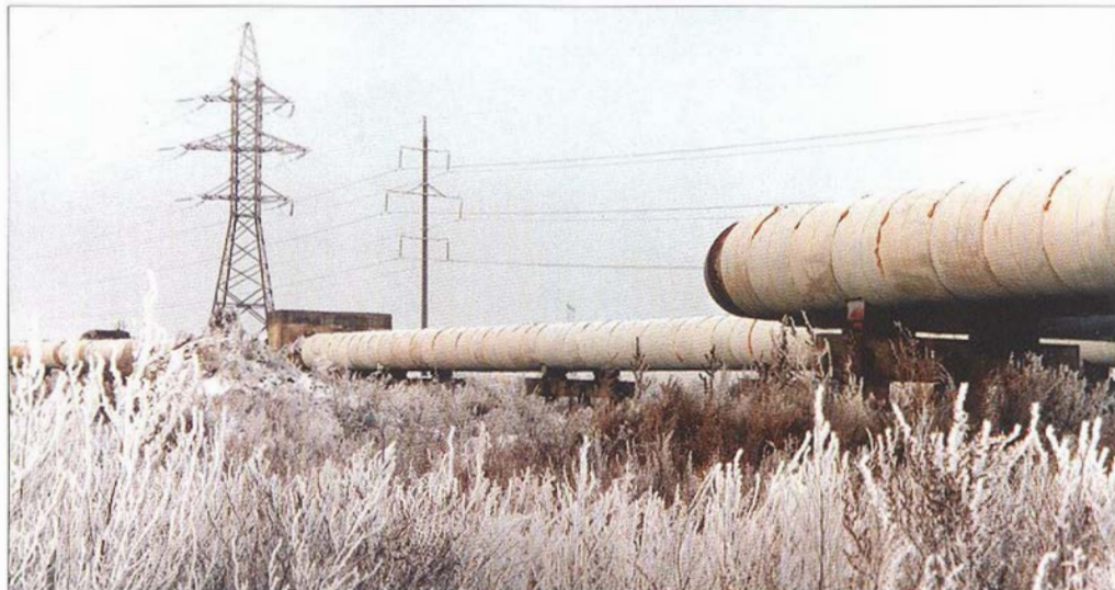
Общий вид трубопровода тепловой сети от ТЭЦ-3 до мкр. Северный ЖК1220 с тепловой изоляцией из скорлупы ППУ
