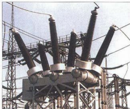
ЦЭС. Силовой элегазовый выключатель фирмы «SIEMENS»
