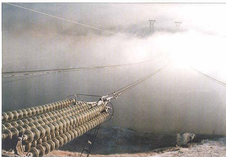
Красноярское предприятие МЭС. ВЛ – 500 кВ. Переход через р. Енисей
