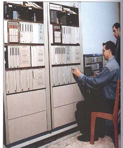
Аппаратура сбора и обработки телеинформации на диспетчерском пункте Северных электрических сетей типа «Аист»
